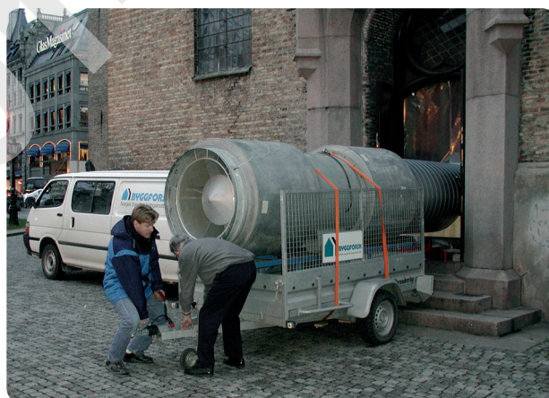
Fig. 222 b Vifte til måling av lufttetthet i store bygninger. Foto: SINTEF Byggforsk
